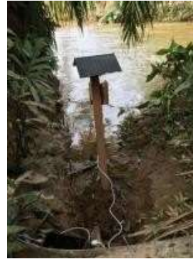
Gambar 1. Instalasi perangkat monitoring salinitas berbasis IoT pada area tambak garam mitra.
